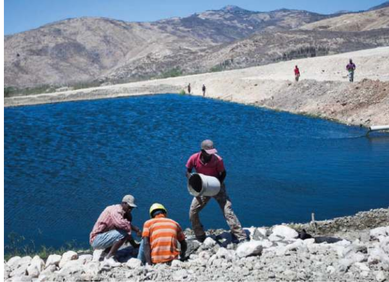
Déversement de boues fécales dans l'étang de stabilisation des eaux usées de Morne à Cabri (Photo crédit: Andrea Martinsen, CDC)
