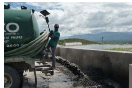
La station d'épuration en plein air de Morne à Cabrit, la seul
